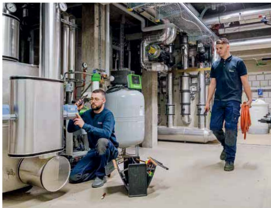
Heizungsinstallateur Florian Rey (links, kniend) und der Lehrling Sandro Jeraj vor der grossen Fernwärmeheizung auf dem Ziegelhof-Areal in Liestal.
