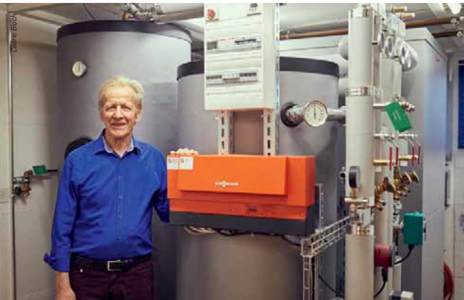
Hans-Peter Hugentobler vor der neuen Heizung.
